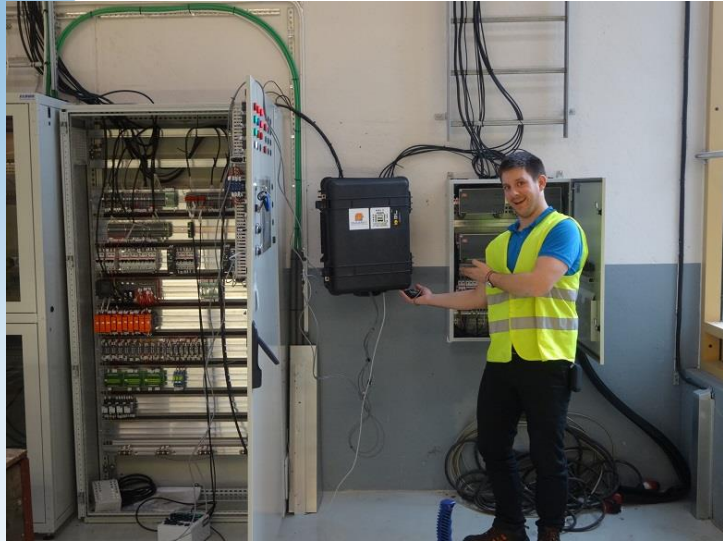
Contrôleur de portes palières installé à Stockholm (ligne Citybanan)
